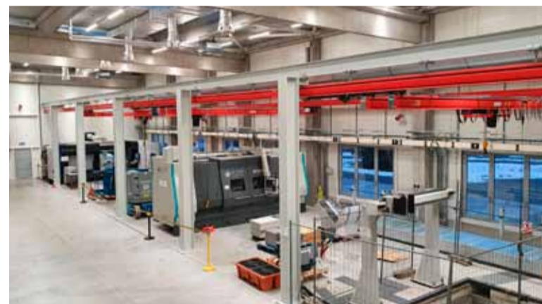
Obr. 2: Realizace manipulačního systému KBK pro Siemens, závod Elektromotory Frenštát
